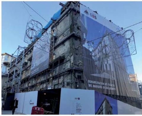
Palacio en C/ Oliva, Vigo- GRUPO DESARROLLA Palacio del S XVII en el Casco Vello en donde se optó por una estabilización interior y exterior con Granshor debido a la estrechez de las calles.
