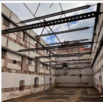
C/ San Quirce 10, Valladolid- GEOXA Rigidizador interior con Superslim en la obra del antiguo Convento de San Quirce y Santa Julita, para la construcción de una residencia geriátrica.
