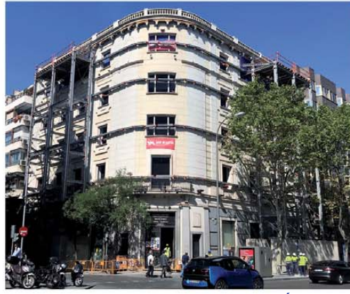
C/ Velázquez 23, Madrid- SAN MARTÍN Las torres Megaprop y el apeo de cornisas permitieron reconvertir este edificio de 1900 en pisos de lujo.
